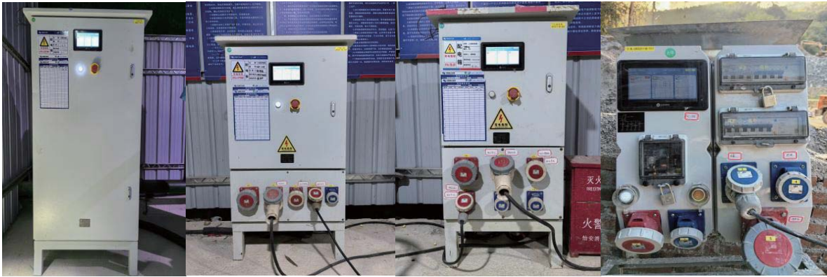
智能配电箱现场应用情况
